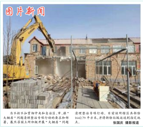
为不折不扣贯彻中央和自治区、市、旗“大棚房”问题清理整治专项行动的要求和部署,旗住建局土土积极开展“大棚房”问题清理整治专项行动。目前该所辖区共拆除1642.79平方米,并将拆除垃圾运送到指定地点。张国庆 摄影报道
