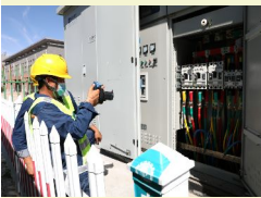
▲电力部门保障考点供电安全
