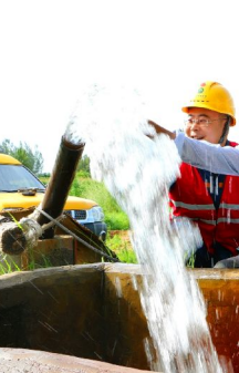
达拉特供电分局发挥部门职能优势,积极解决农牧区机井用电问题,确保农田灌溉顺利进行。
